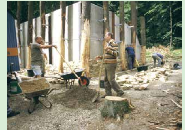
Die historische Rekonstruktion muss heutigen statischen Anforderungen entsprechen: Stahlträger wurden in bis zu 3 Meter tiefe Bohrlöcher hydraulisch eingepresst. Dazwischen kamen vorgefertigte Betonplatten.
