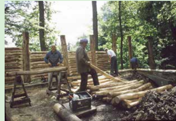
Rundhölzer wurden abgelängt, geschält und an den Enden verjüngt. Der Einbau erfolgte in Schlitze in den senkrechten Pfosten.
