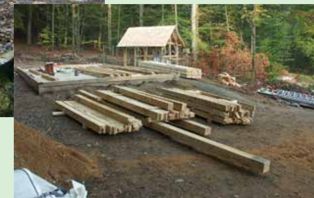
Das Stammholz wurde im Wald mit einer mobilen Sägeanlage zu Balken geschnitten und später von einer Zimmerei abgebunden und zugeschnitten.
